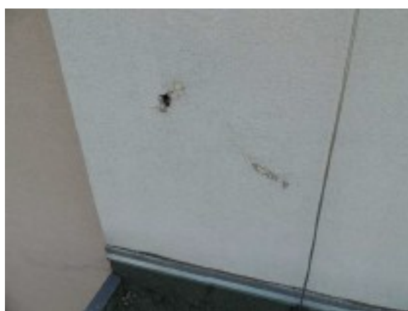
Poškodenia zateplenia – otvory, trhliny
