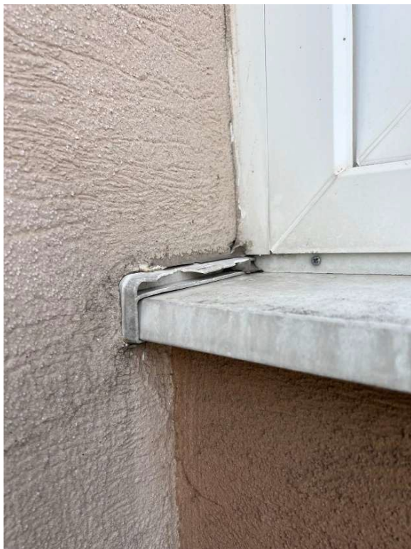
Poškodené koncovky parapetov
