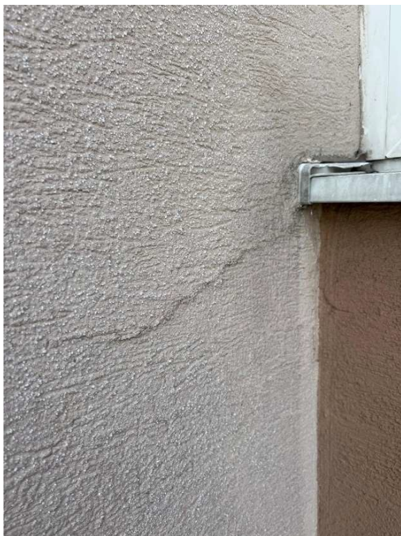
Poškodené koncovky parapetov a trhliny
