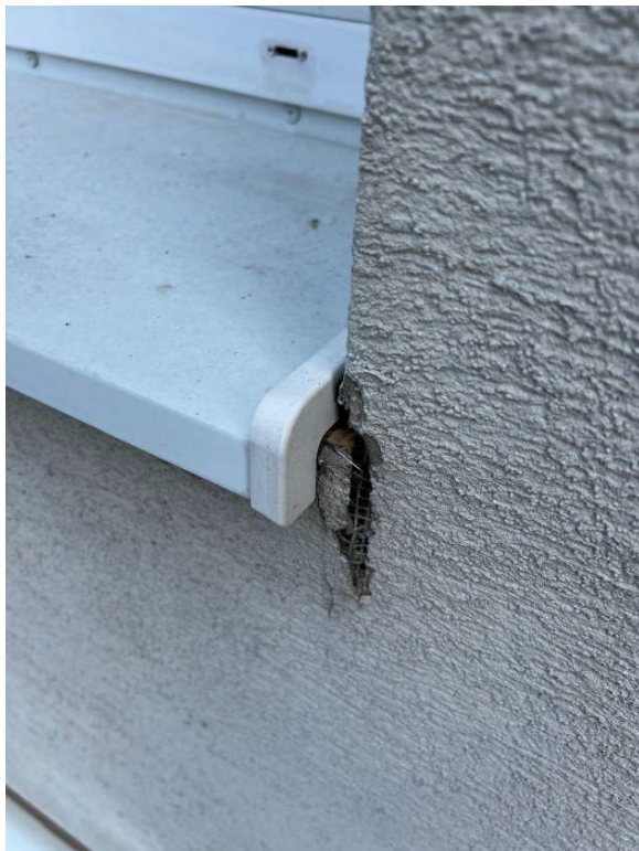
Poškodené koncovky parapetov a trhliny
