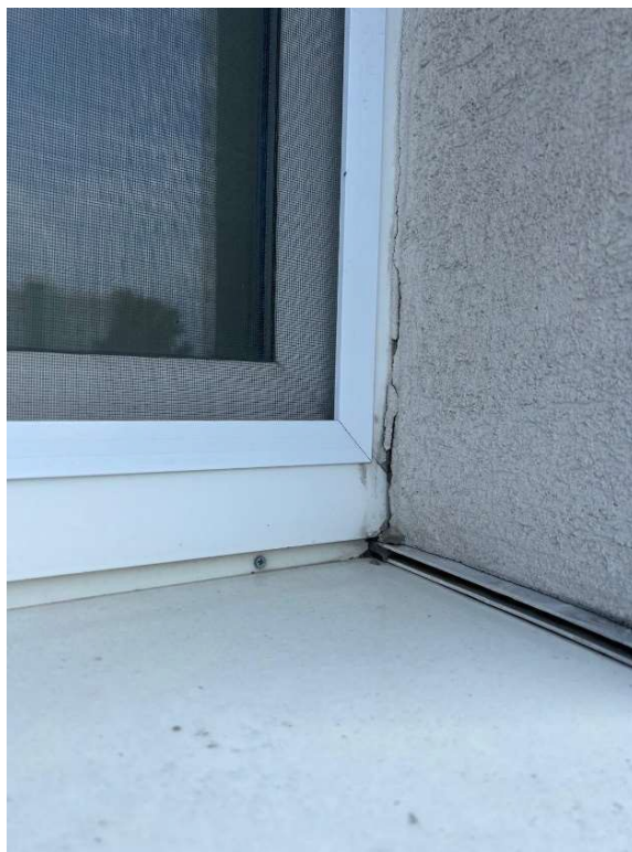
Poškodené koncovky parapetov a trhliny
