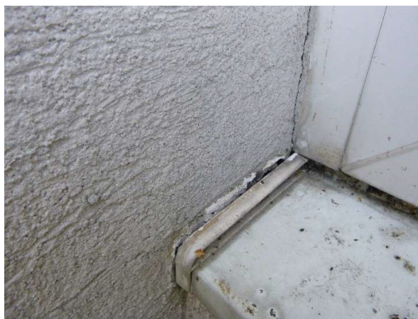
Poškodené zateplenie pri oknách
