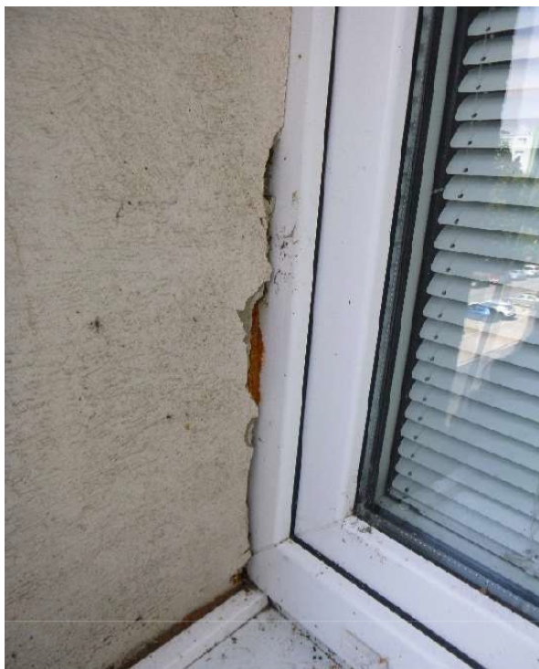
Poškodené koncovky parapetov a trhliny
