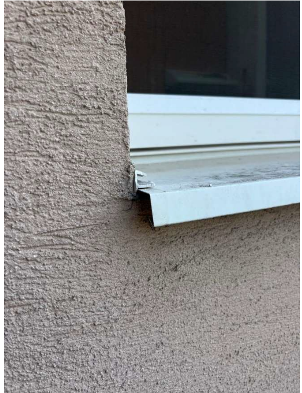
Poškodené koncovky parapetov
