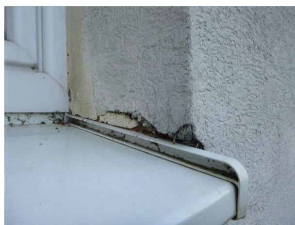
Poškodené zateplenie pri oknách
