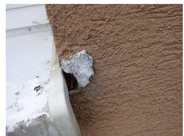
Poškodené zateplenie pri oknách
