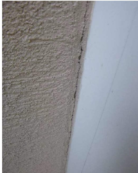
Trhliny pri oknách
