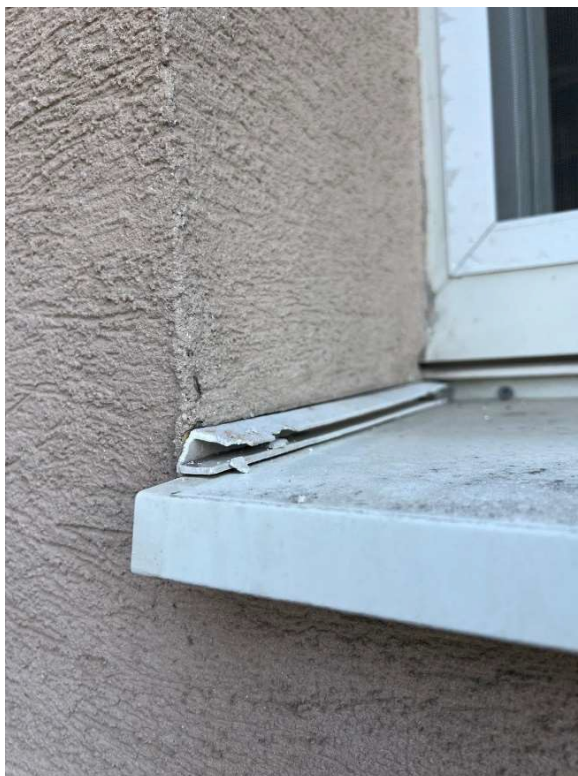
Poškodené koncovky parapetov
