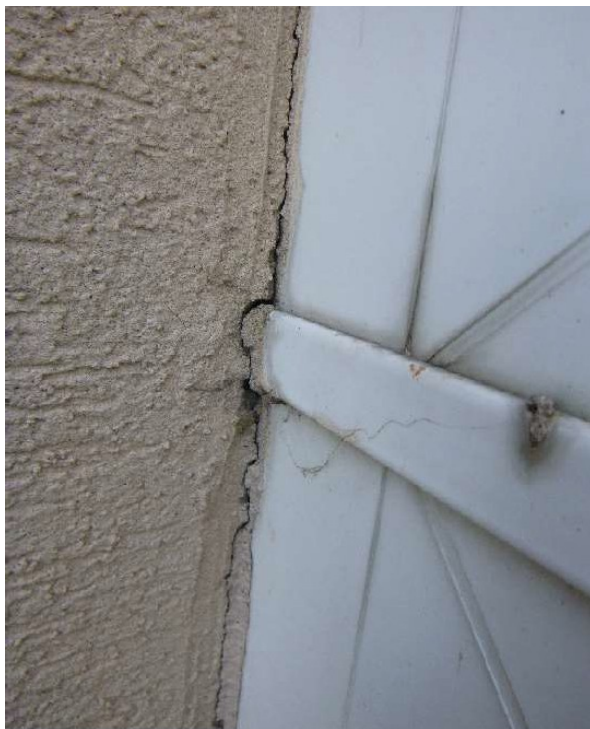
Trhliny pri oknách
