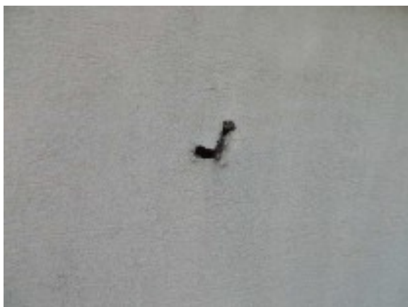
Poškodenia zateplenia – otvory, trhliny
