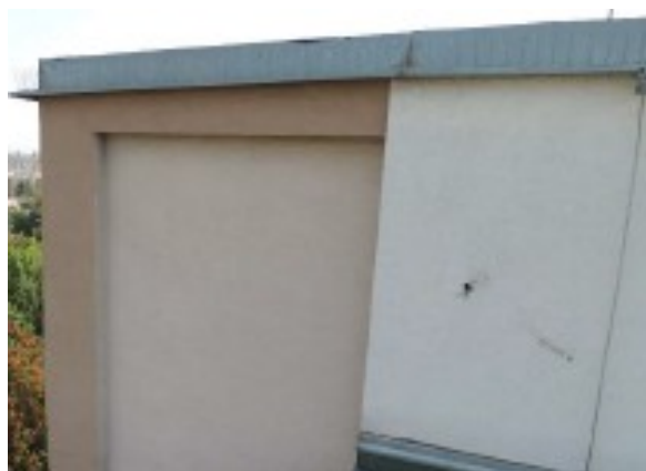
Poškodenia zateplenia – otvory, trhliny
