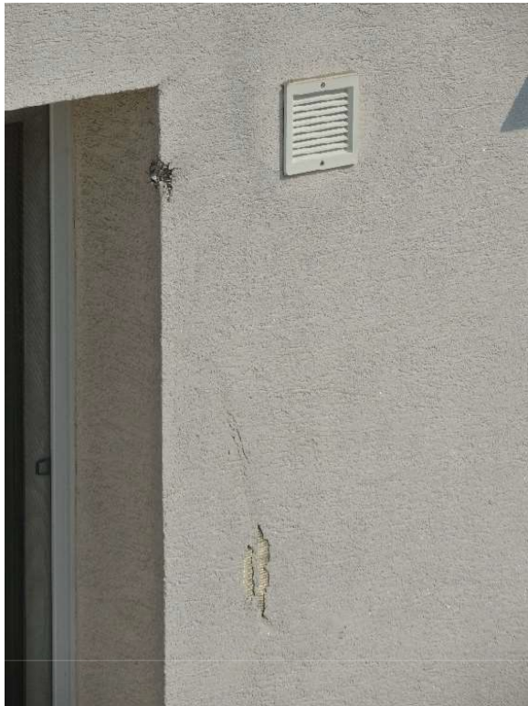
Poškodené zateplenie pri oknách
