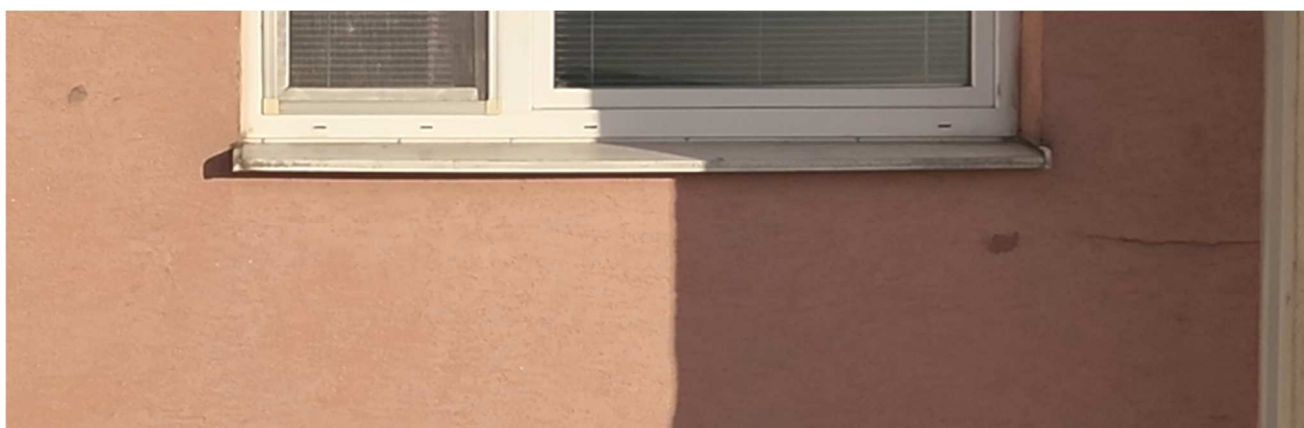
Výskyt prasklín a poškodenia v ploche zateplenia
