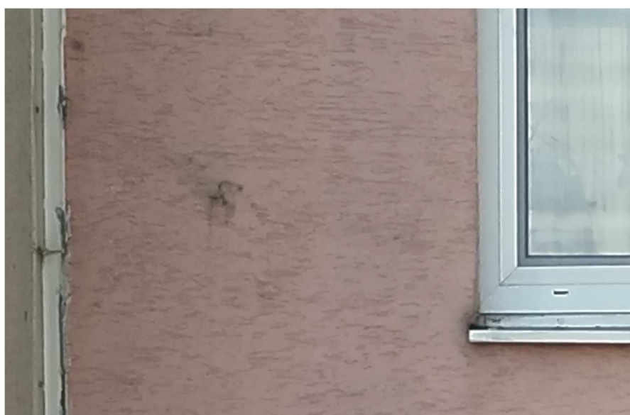
Výskyt prasklín a poškodenia v ploche zateplenia
