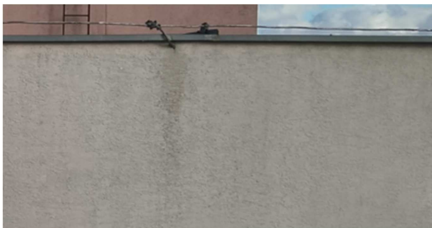
Poškodený povrch fasády v mieste prestupu bleskozvodového vedenia do zateplenia
